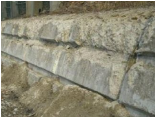
옹벽 마모 현상
