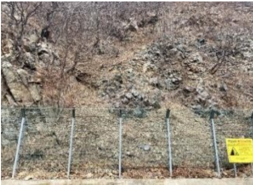
테일러스 붕괴(유실 및 붕괴)
