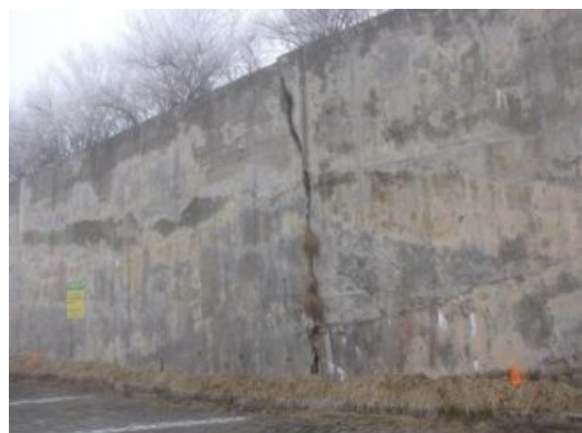
종방향 균열 발생
