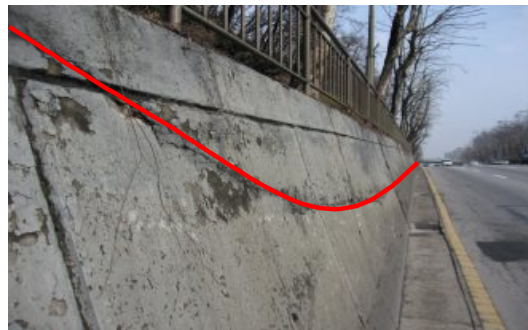
〈그림 3-63〉 전면부의 횡방향 균열
