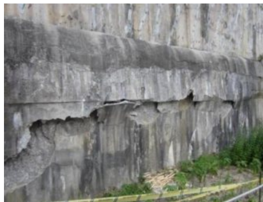
〈그림 3-121〉 덧댐콘크리트 들뜸, 탈락
