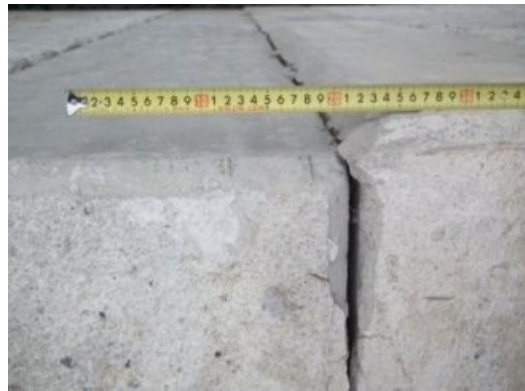
옹벽 침하에 의한 단차발생
