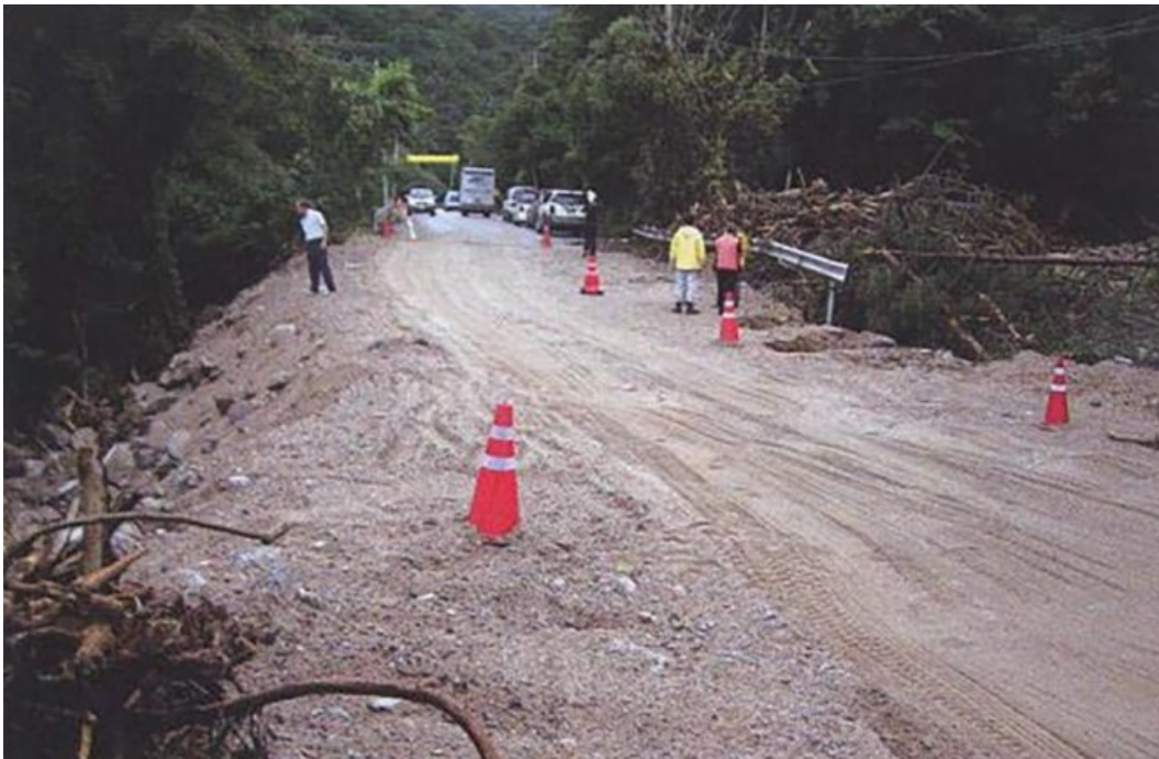
〈그림 3-117〉 유송잡물에 의한 배수기능상실로 인한 붕괴사례
