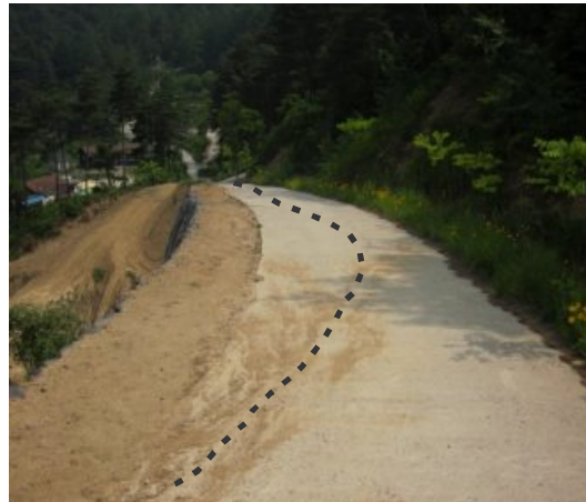
〈그림 3-153〉 배면의 콘크리트 포장균열(2)
