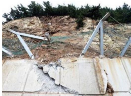
상부 낙석 발생에 의한 옹벽 파손
