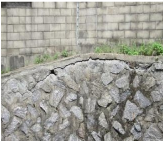
〈그림 3-154〉 석축 상부 균열
