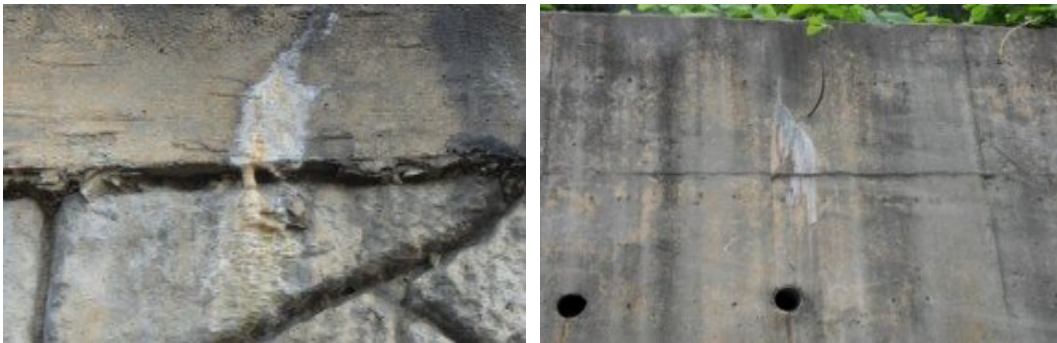
〈그림 3-66〉 콘크리트 열화
