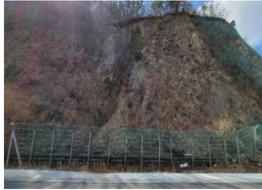
붕괴(급경사지 상부 산지 경계)
