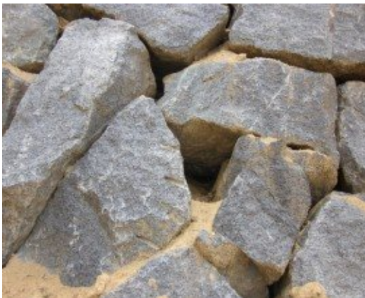
〈그림 3-146〉 쌓기돌 이완 및 공동 발생
