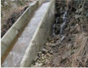
배수로 확대 시공 필요
