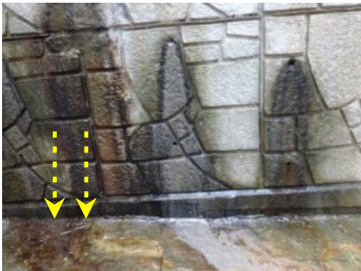
옹벽 하단부 침하
