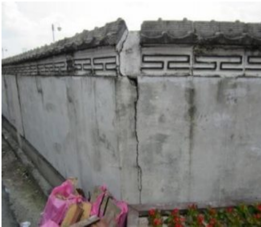
〈그림 3-156〉 옹벽상부 담장 균열
