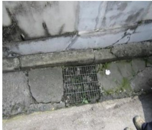
〈그림 3-159〉 노견 배수로 막힘 및 파손
