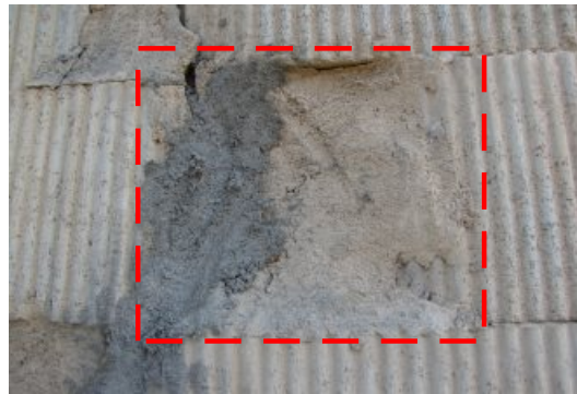
〈그림 3-70〉 전면부의 파손
