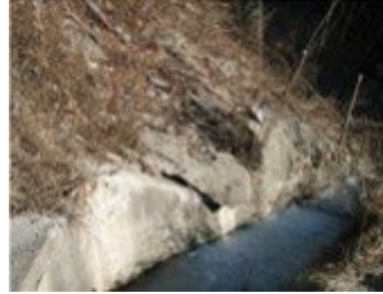
재시공 필요 파손 배수로
