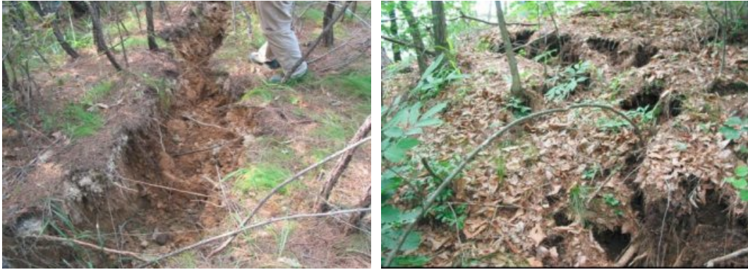
〈그림 9-49〉 비탈면 상부 및 내부 인장균열
