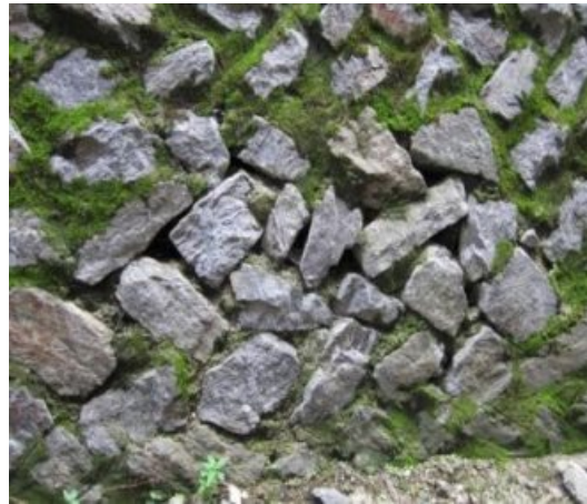
〈그림 3-157〉 모르타르의 열화 및 탈락
