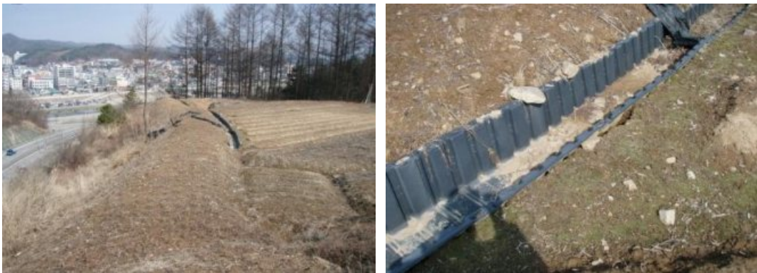
〈그림 3-38〉 깎기비탈면 상부 전답에 존재하는 붕괴 발생 요인 배수구
