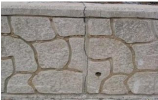
〈그림 3-62〉 전면부의 종방향 균열
