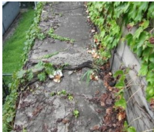
〈그림 3-155〉 상단 콘크리트 균열
