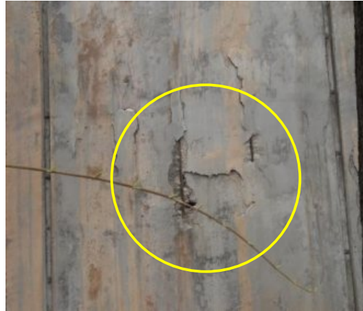
〈그림 3-127〉 철근노출 및 박락 상태
