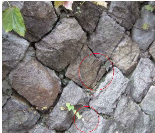
〈그림 3-169〉 석축 상부 담장 균열
