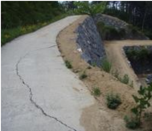
〈그림 3-152〉 배면의 콘크리트 포장균열(1)
