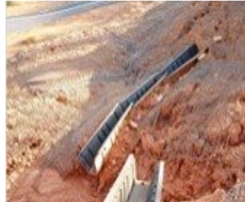
배수불량에 의한 붕괴
