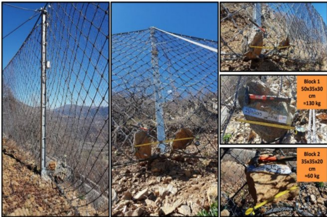
〈부도 2-42〉 이탈리아 지반위험 모니터링 그룹이 설치한 스마트 네트워크
