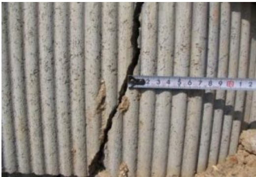
〈그림 3-69〉 전면부의 균열
