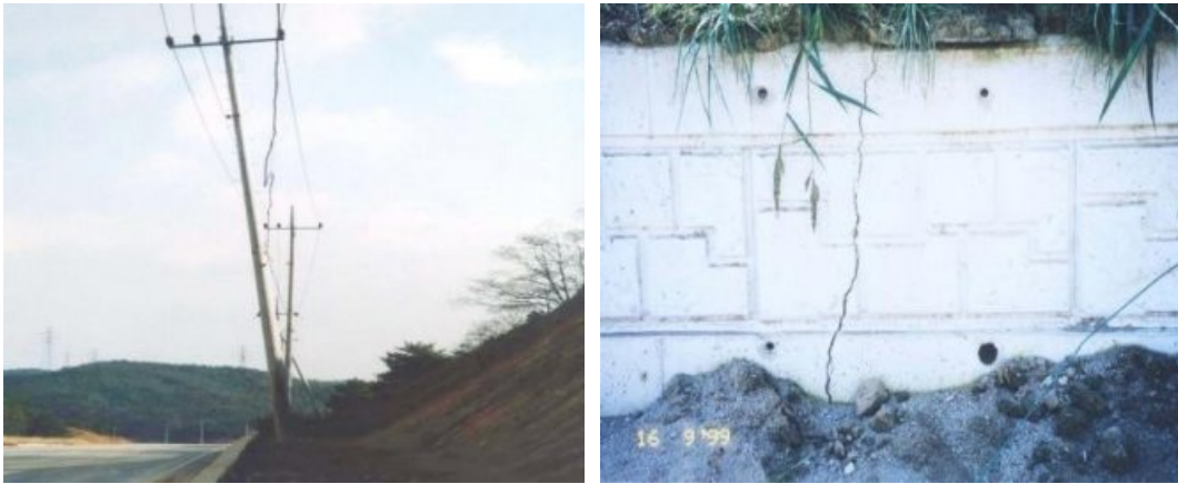
〈그림 9-53〉 전신주 기울어짐(좌) / 옹벽 균열(우)
