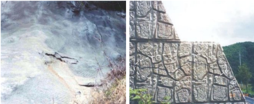
〈그림 9-54〉 숏크리트 균열(좌) / 계단식옹벽 균열(우)
