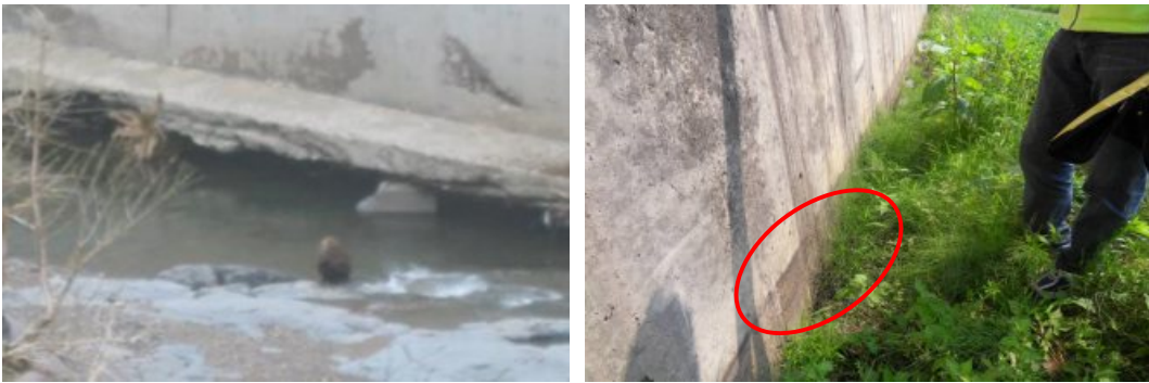
〈그림 3-59〉 옹벽 기초부 세굴 상태 및 흔적
