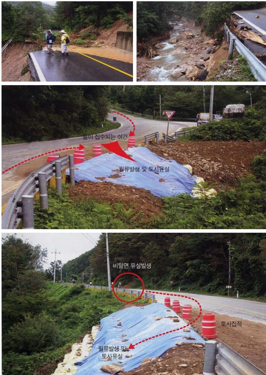
〈그림 3-111〉 쌓기비탈면 유실 및 노면수 도로유입에 의한 붕괴사례
