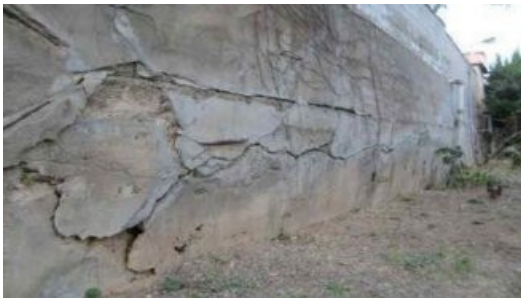
콘크리트 옹벽 배부름 현상
