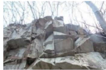
균열 및 절리
