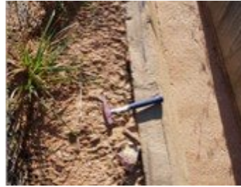
배수로 애프론 미설치 불량 사례
