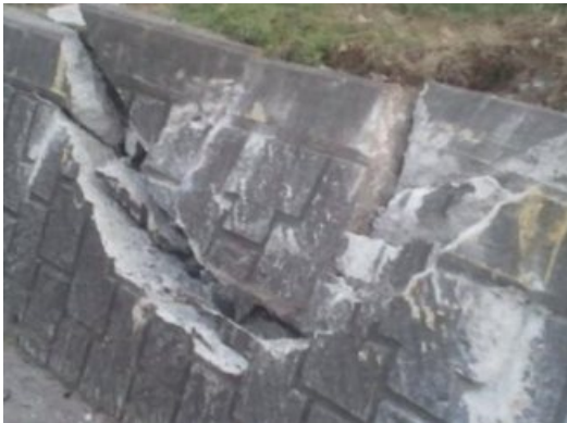
충격에 의한 옹벽 손상
