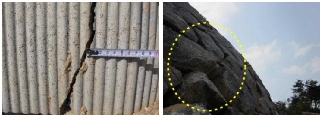
〈그림 9-47〉 보강토옹벽 균열(좌) / 석축 배부름(우)
