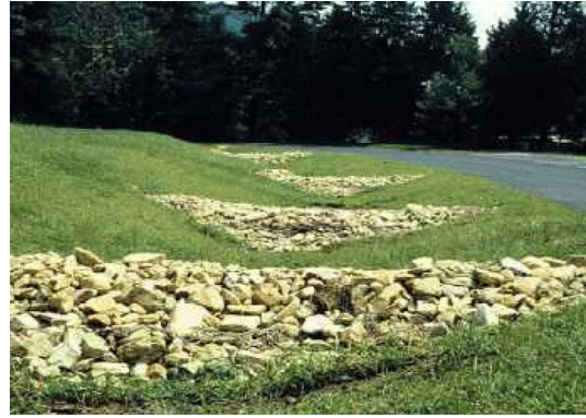
(b) 초지수로(check dam 설치)
