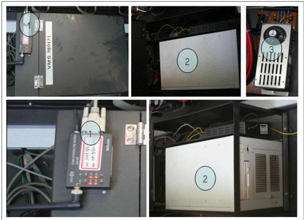
<그림 25> VMS 제어부의 제어PC, 온도센서 내·외부
