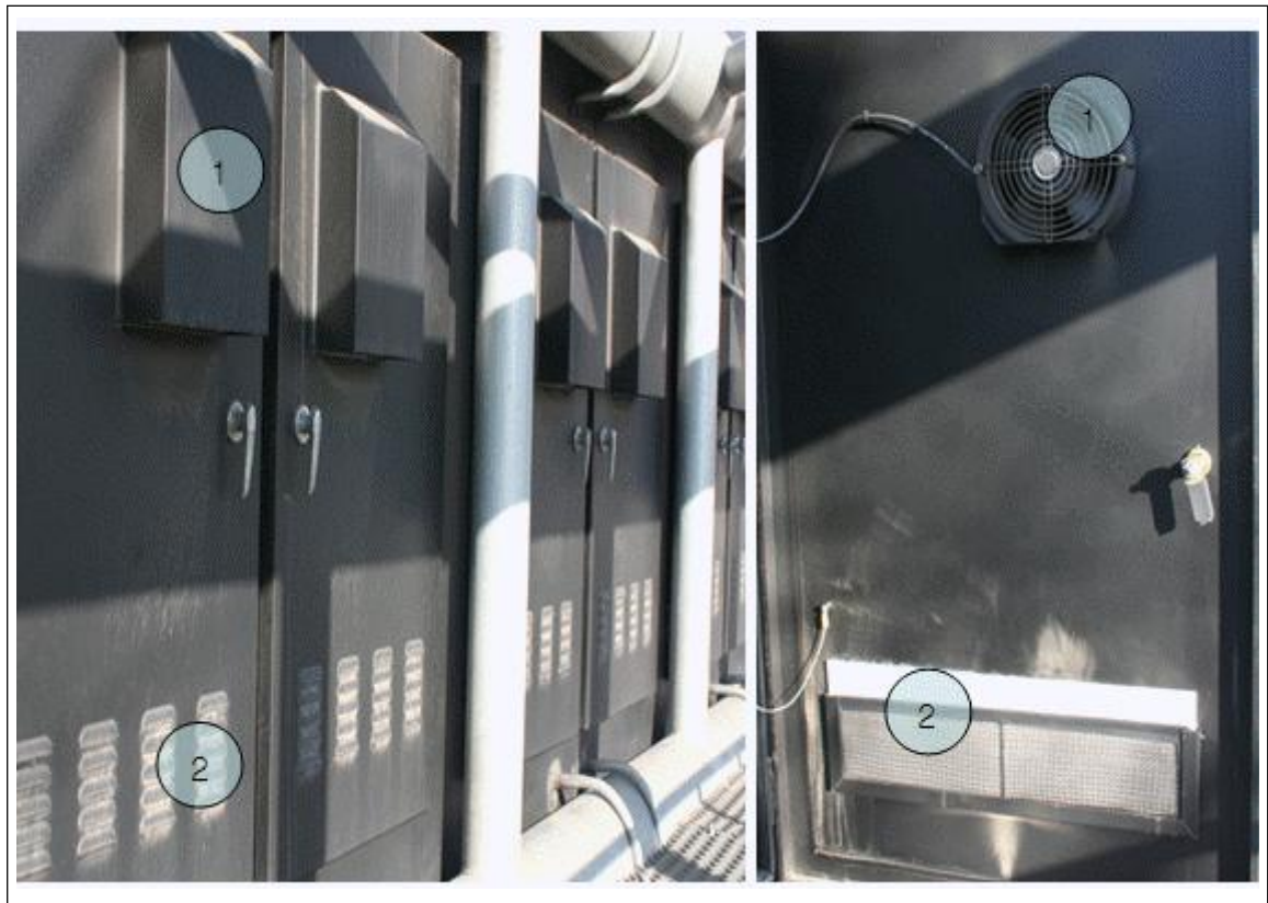
<그림 26> VMS 제어부의 환기팬(Fan) 내·외부
