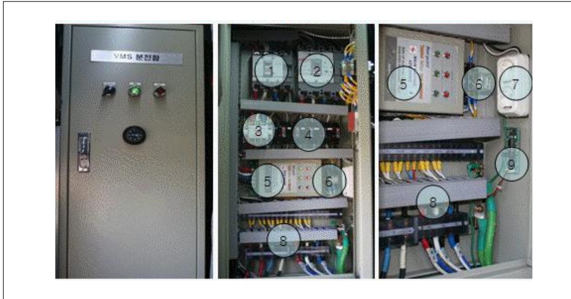
<그림 28> VMS 전원부의 전원분전함 내·외부
