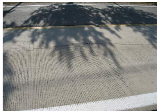
세로 균열 - 심각도 : 중
