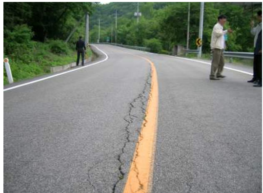
시공 균열 - 심각도 : 상
