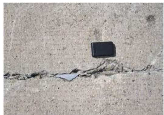
줄눈재 파손 - 심각도 : 상
