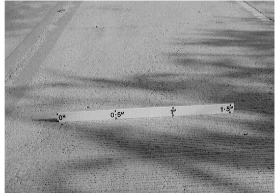
대각선 균열 - 심각도 : 하
