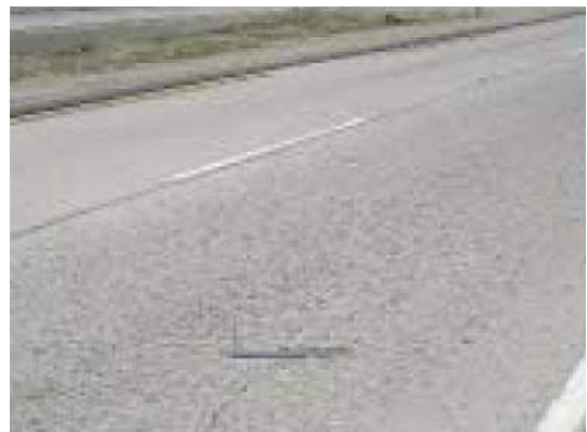
세로 균열 - 심각도 : 하
