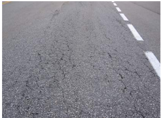
거북등 균열 - 심각도 : 중
