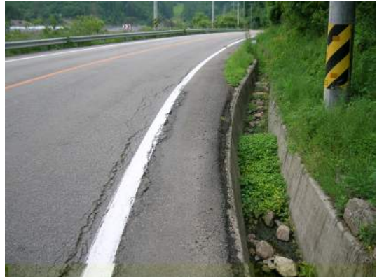
차로와 길어깨 줄눈 균열 - 심각도 : 중
