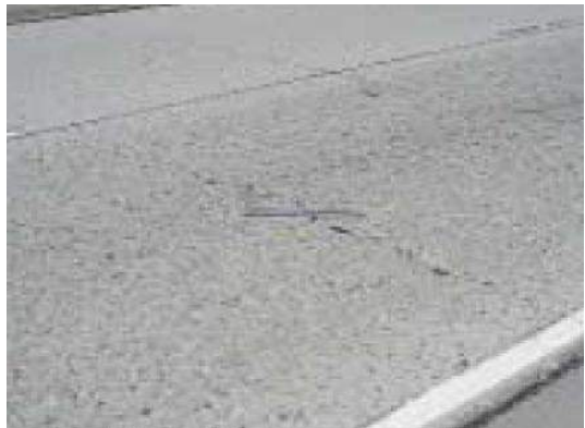
가로 균열 - 심각도 : 상
