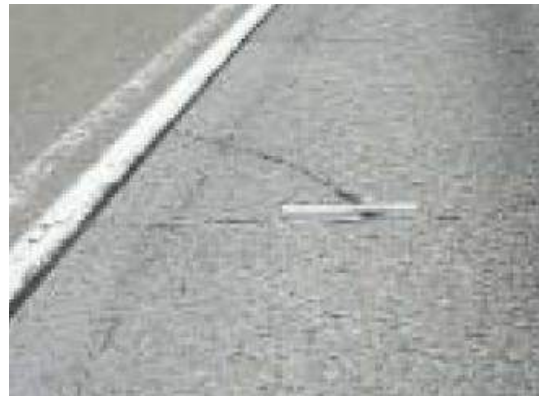
우각부 균열 - 심각도 : 중
