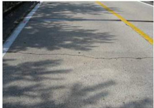
가로 균열 - 심각도 : 중
