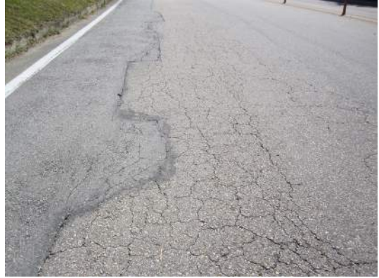
지하매설물 설치부 함몰 1
