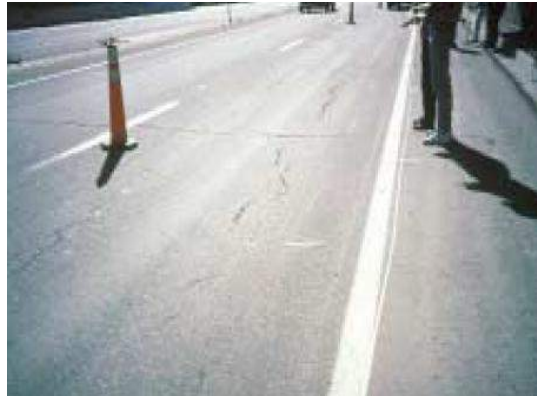
거북등 균열 - 심각도 : 하
