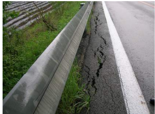
단부 균열 - 심각도 : 중
