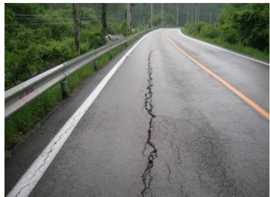
세로 방향 균열 - 심각도 : 상
