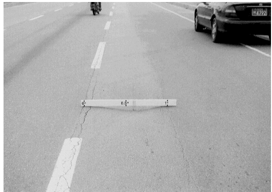
지하매설물 설치부 함몰 3
