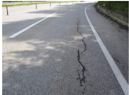
세로 방향 균열 - 심각도 : 중
