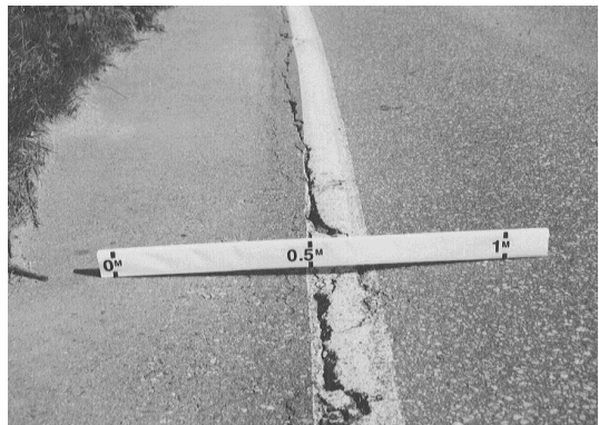
차로와 길어깨 줄눈 균열 - 심각도 : 상
