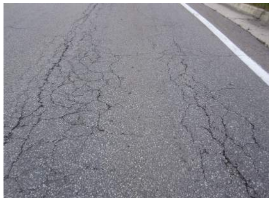
거북등 균열 - 심각도 : 상
