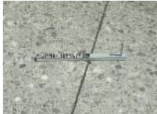
줄눈재 파손 - 심각도 : 하
