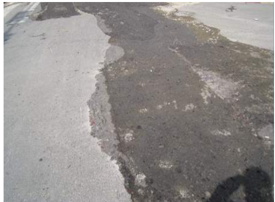
지하매설물 설치부 함몰 2
