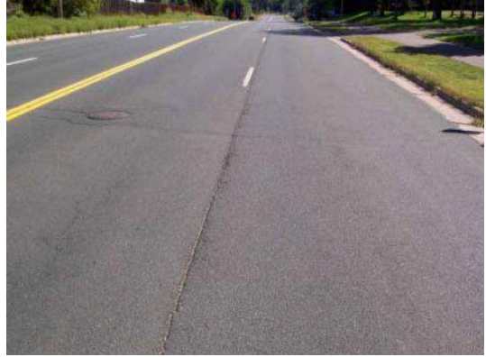
시공 균열 - 심각도 : 하
