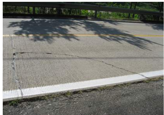
우각부 균열 - 심각도 : 상
