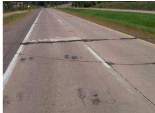
대각선 균열 - 심각도 : 중
