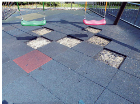
[X] 노후화 및 파손된 바닥포장 방치
