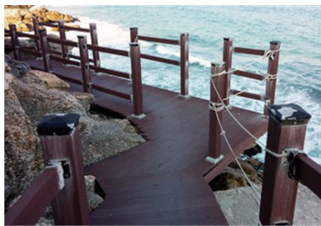
[X] 파손된 해안산책로 데크의 방치 및 관리부족
