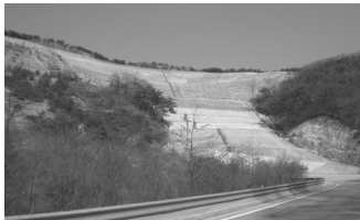
[사진 3-59] 도로로 인한 산악의 훼손
