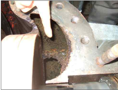
취수펌프 3호기 흡입측 손상
