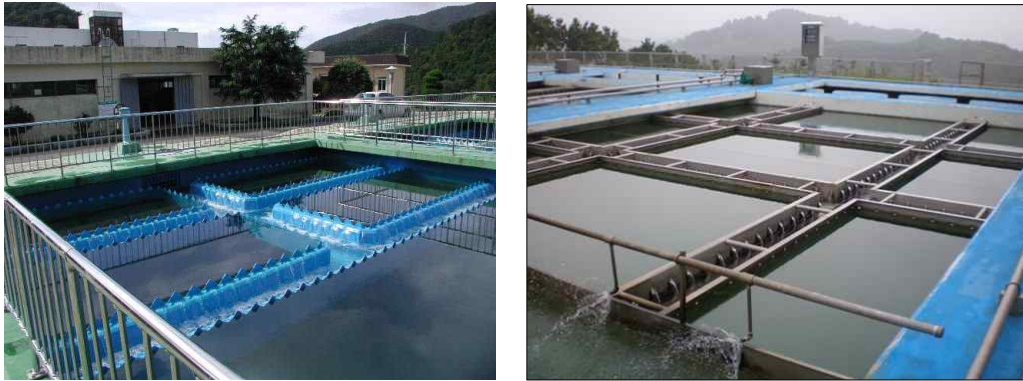
위어식 및 오리피스식 트러프 설치 예 (우측 : 옥룡정수장)
