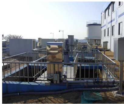
생활용수계통 혼화지(1지) 전경
