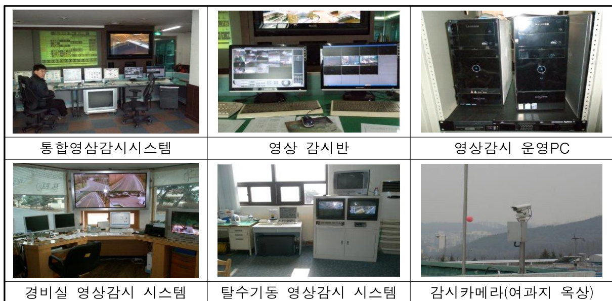
<그림 5.2-79> CCTV설비 사진
