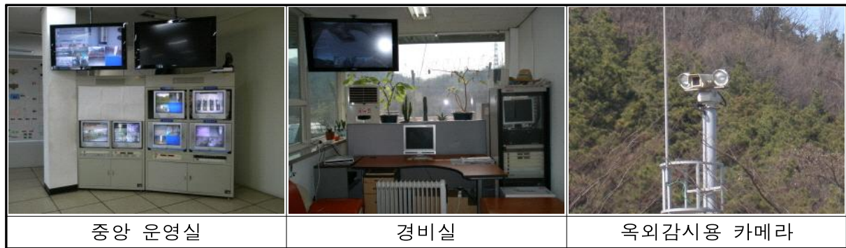
<그림 5.2-89> CCTV설비 사진
