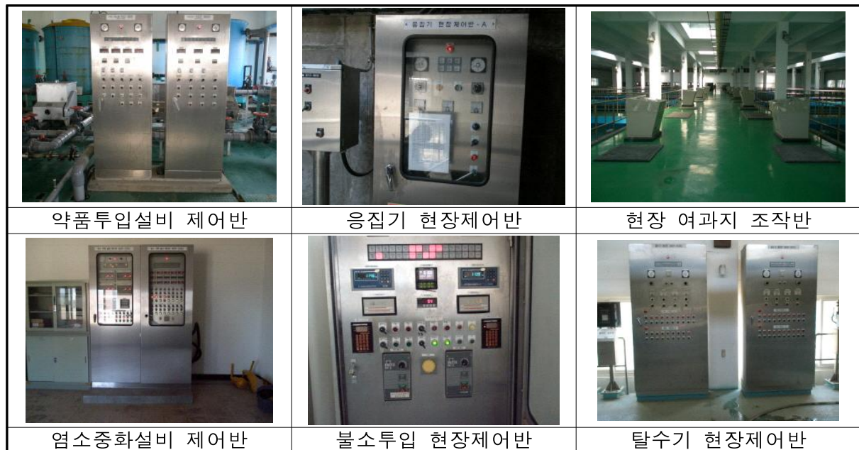
<그림 5.2-83> 현장 제어반 사진
