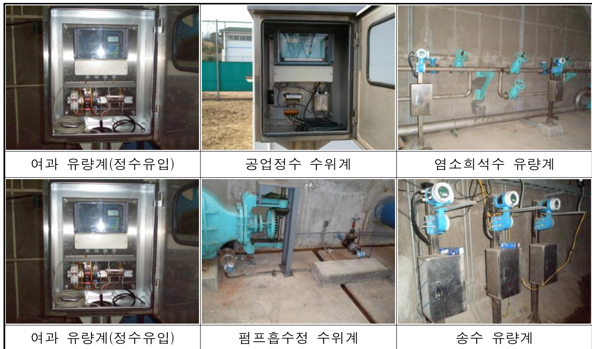
<그림 5.2-85> 현장 계측기기 사진(여과 및 정수설비)
