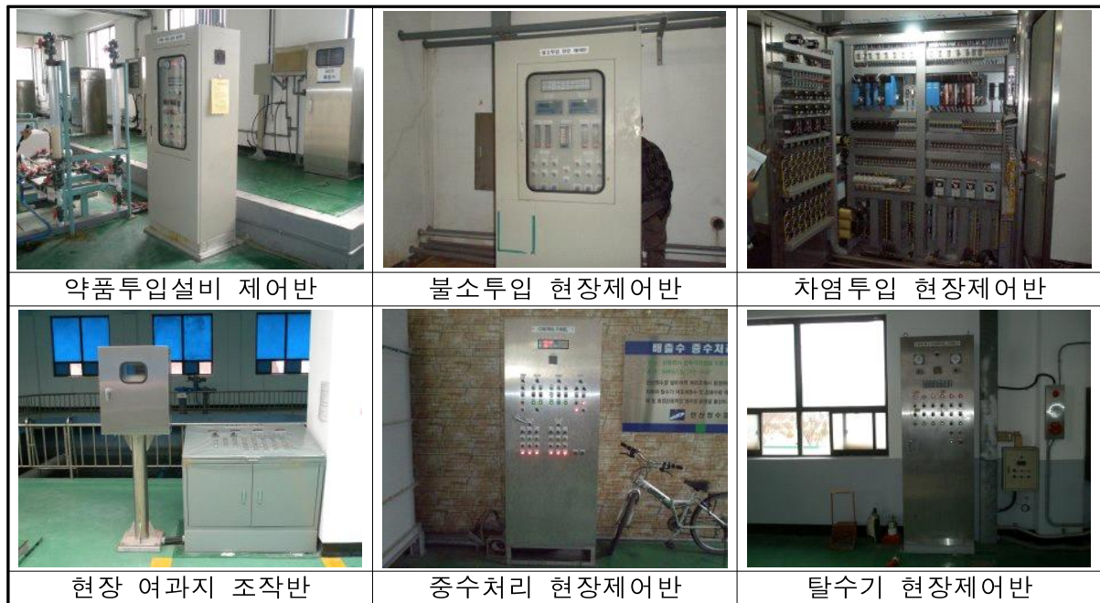
<그림 5.2-74> 현장 제어반 사진
