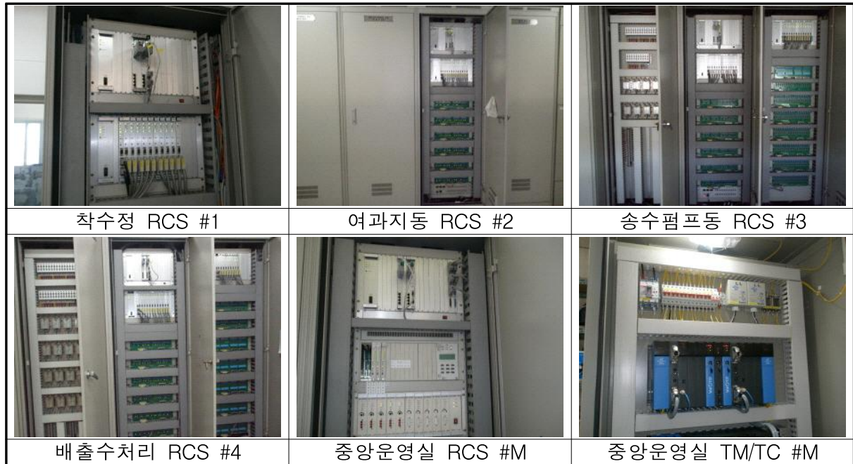
<그림 5.2-81> 현장 제어반 사진
