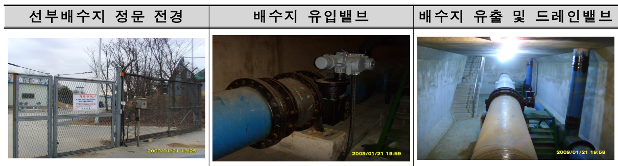
<그림 5.4-2> 배수지 설치현황
