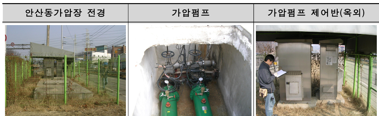
<그림 5.4-82> 안산동가압장 설치현황
