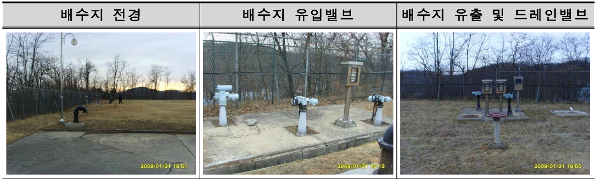
<그림 5.4-4> 배수지 설치현황
