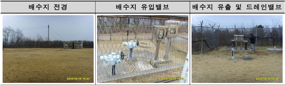
<그림 5.4-12> 배수지 설치현황
