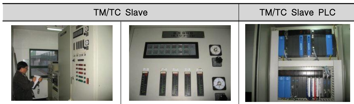
<그림 5.4-24> 선부2 배수지 현장제어반
