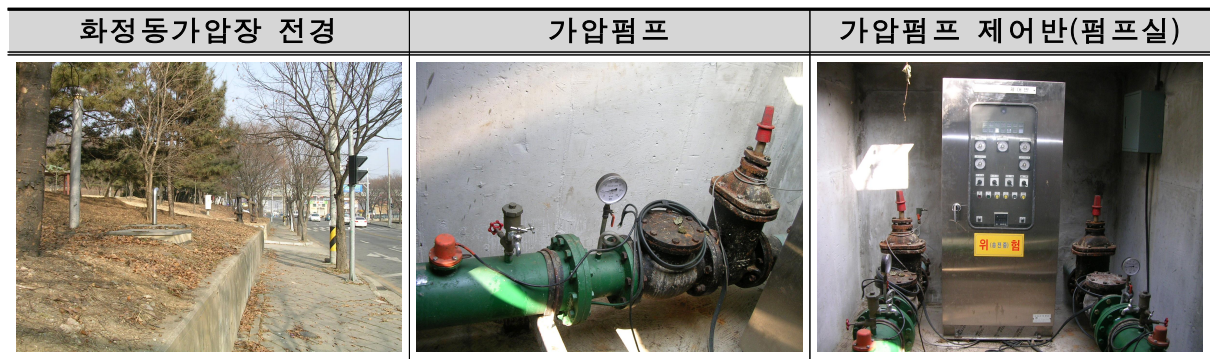
<그림 5.4-78> 화정동가압장 설치현황
