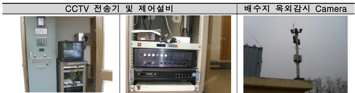
<그림 5.4-55> CCTV 설비
