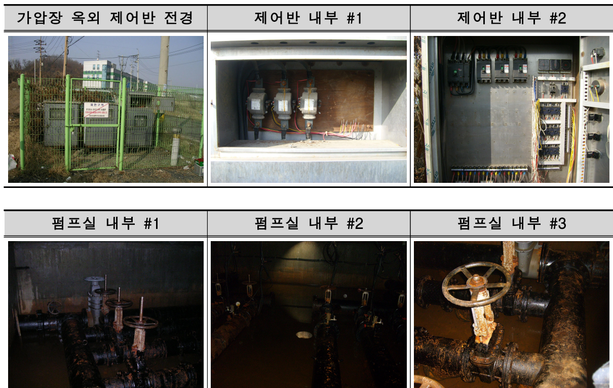
<그림 5.4-91> 가압장 설치현황
