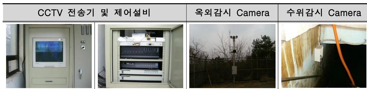
<그림 5.4-41> CCTV 설비
