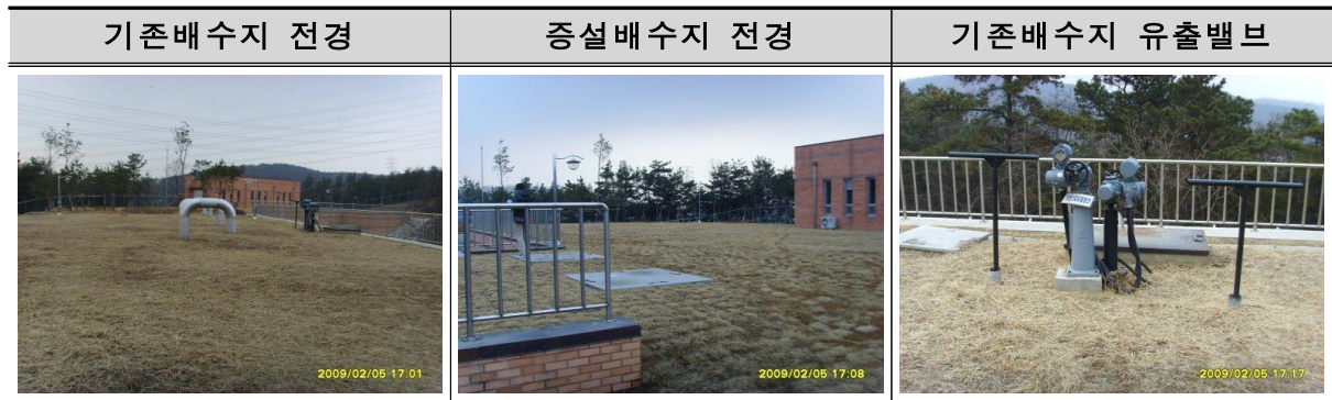
<그림 5.4-22> 배수지 설치현황
