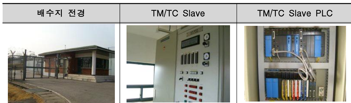
<그림 5.4-47> 성포 배수지 현장제어반
