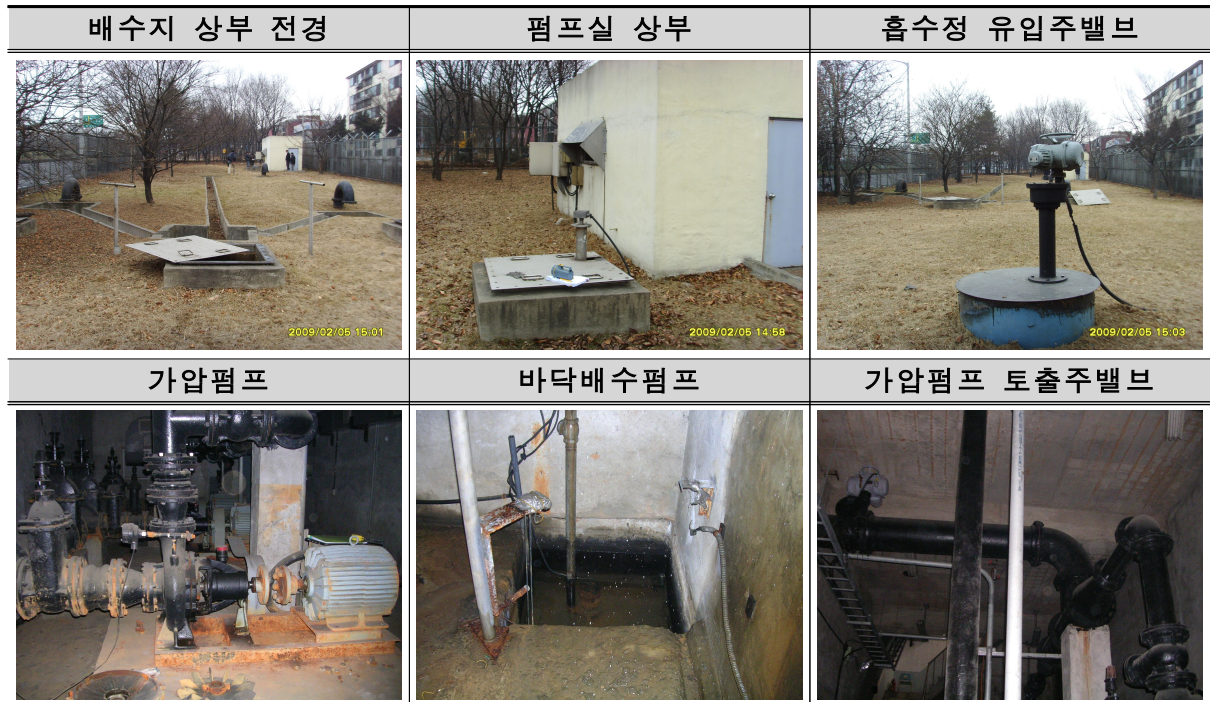
<그림 5.4-74> 가압장 설치현황
