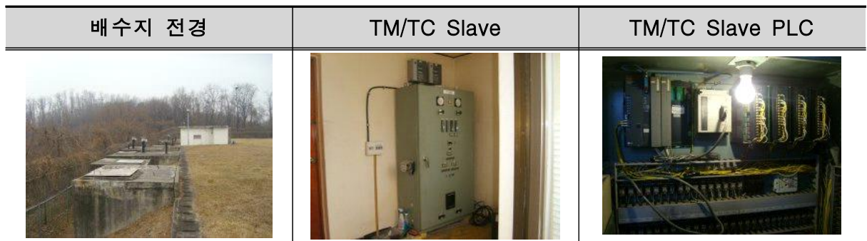
<그림 5.4-42> 와동 배수지 현장제어반
