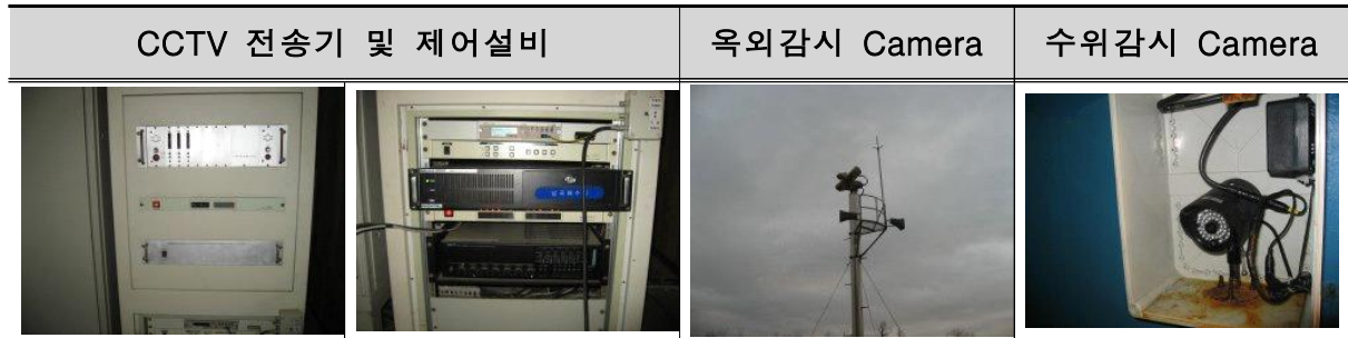
<그림 5.4-29> CCTV 설비
