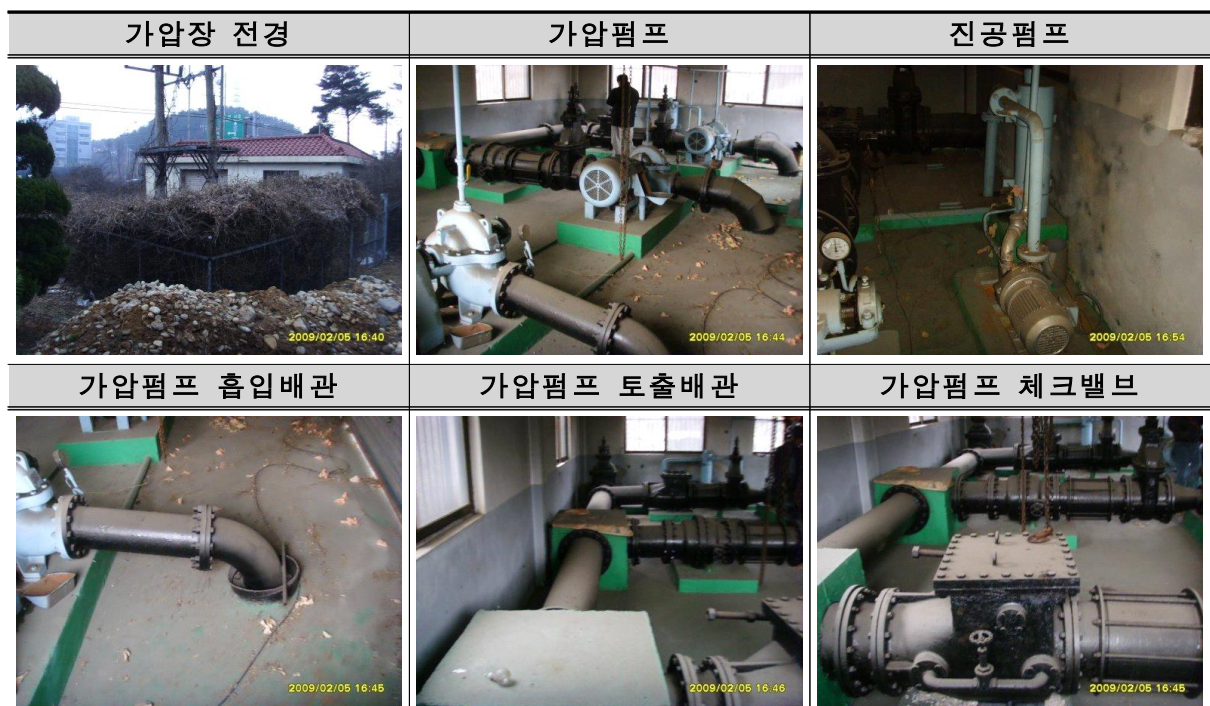
<그림 5.4-66> 가압장 설치현황
