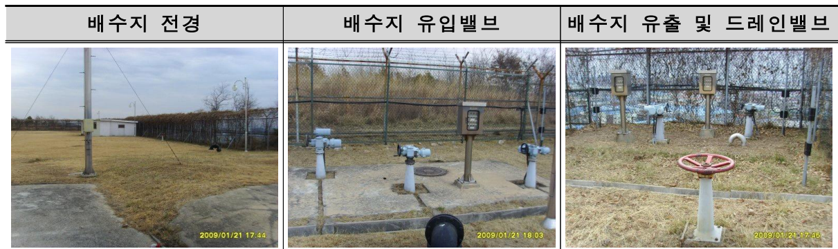
<그림 5.4-6> 배수지 설치현황
