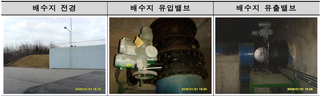
<그림 5.4-8> 배수지 설치현황
