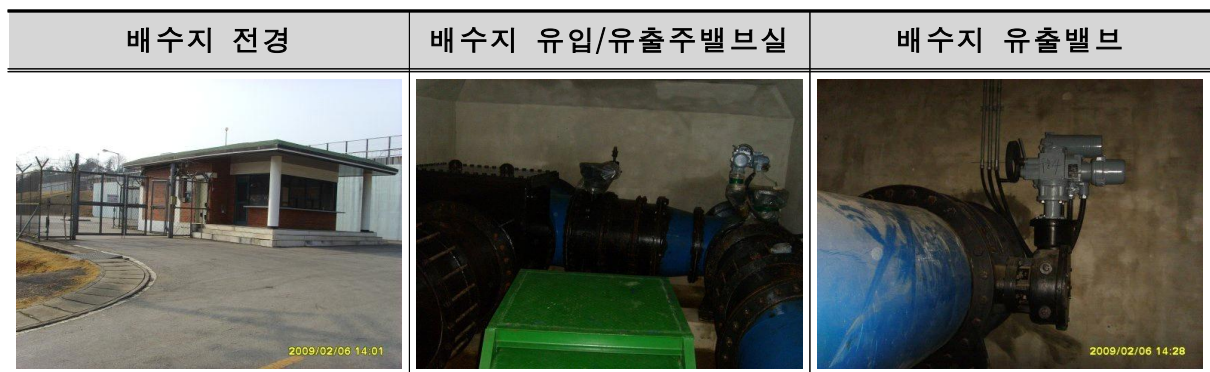
<그림 5.4-16> 배수지 설치현황
