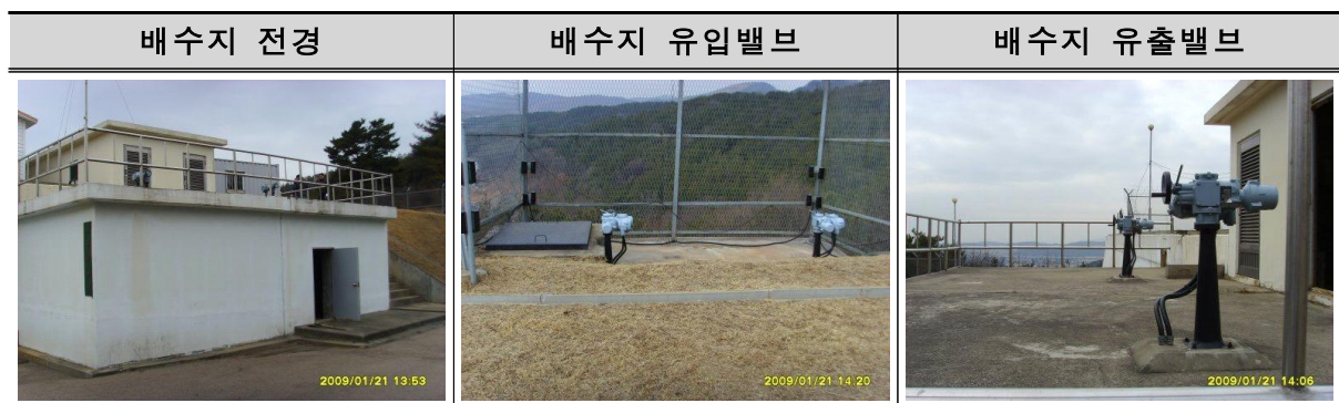
<그림 5.4-10> 배수지 설치현황
